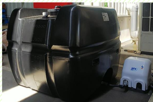
タンク・ポンプ
